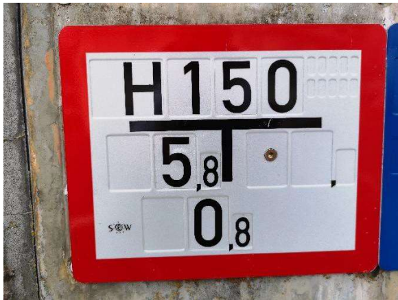
Hinweisschild zum Auffinden eines Hydranten
