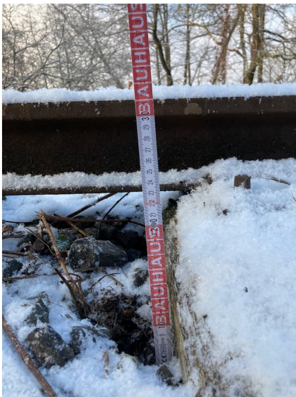
Abbildung 13-5: Freiliegende Schwellen auf der Strecke
