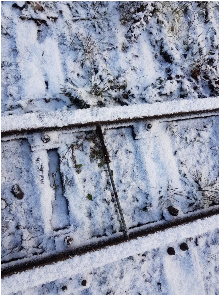
Abbildung 13-6: Verfaulte Holzschwellen, Schienen werden mit Gewindestangen zusammengehalten
