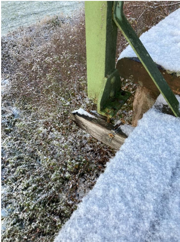
Abbildung 13-2: Verrottete Befestigung Brückengeländer
